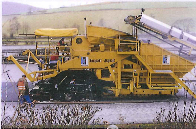
Bild 2: Erstmaler Einbau einer Kompakten Asphaltbefestigung mit dem Kompaktmodulfertiger, BAB A 7 „Reckeröder Berg“, untere Schicht 9,5 cm ABi 0/22 S mit Straßenbaubitumen B 65 und 1,2 % Naturasphalt und obere Schicht 2,5 cm SMA 0/8 S mit Polymermodifiziertem Bitumen PmB 45 A (Bild: Kirchner Holding GmbH)
