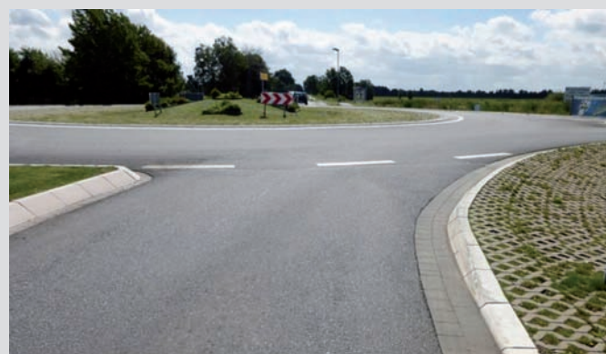
Bild 8: Kreisverkehr nördlich von Aurich mit dichter und ebener Beschaffenheit der Oberfläche der im Dezember eingebauten Asphaltdeckschicht aus Asphaltbeton AC 11 D S mit 25/55-55 A RC und 1,5 % VvoZ nach gut 2,5 Jahren Nutzung
